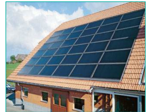
Panneaux photovoltaïques intégrés © Batirama
