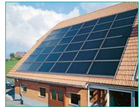
Panneaux photovoltaïques intégrés © Batirama
