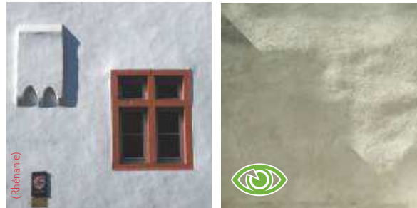
Les supports les plus anciens sont parfois très irréguliers. L'enduit doit suivre ces irrégularités, sans chercher ni à les masquer, ni à les accentuer.
